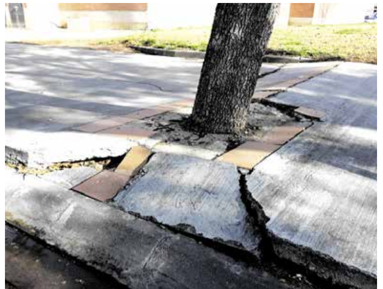
Les voreres necessitaven una actuació que ja ha començat.
