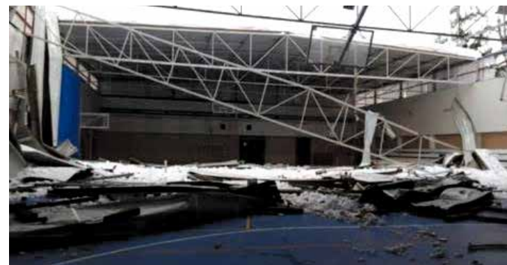
Planta baixa afectada per la caiguda de part d'un sostre a Horta i imatge del pavelló de Vallderrores.
