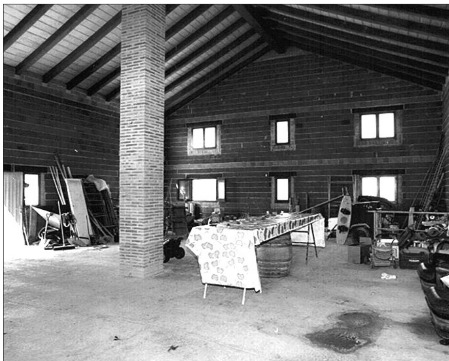
Construcció afectada dies abans de l'enderroc.
